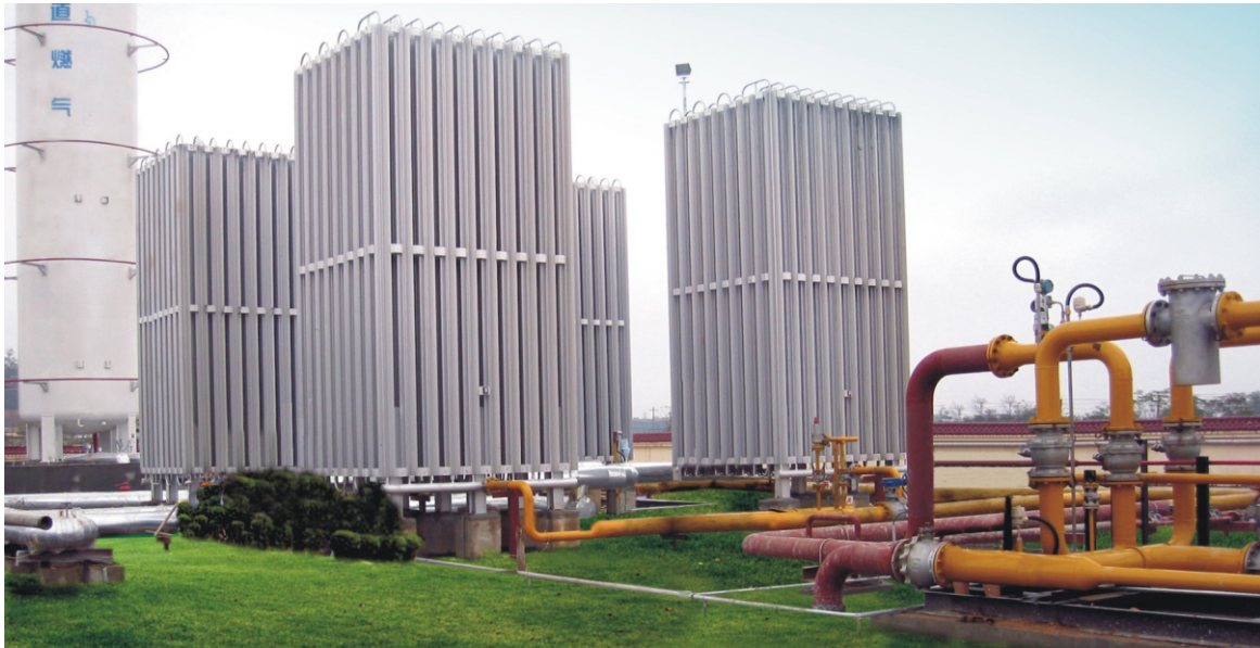
LNG气化站（撬）
